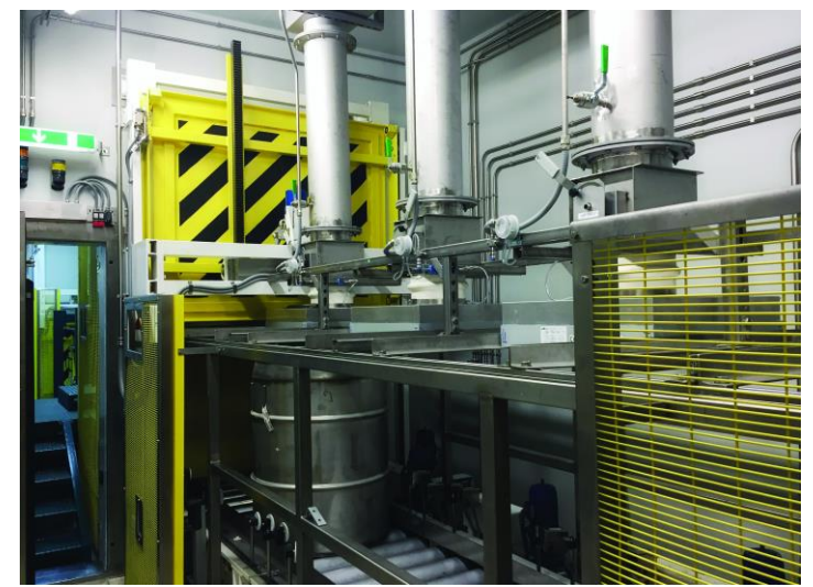
Impianto Estrazione e Condizionamento omogeneo fanghi radioattivi - Latina
