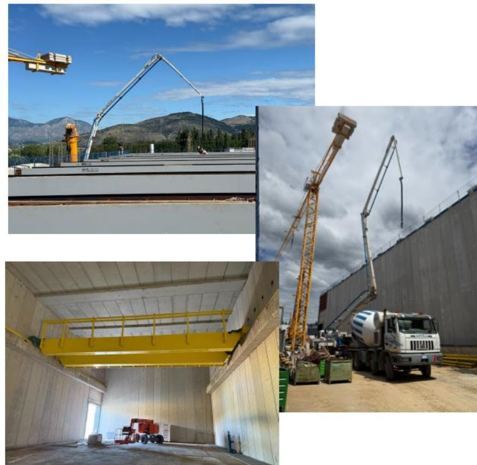
Nuovo deposito temporaneo per manufatti cementati di bassa e media attività (LLW - ILW)- Garigliano
