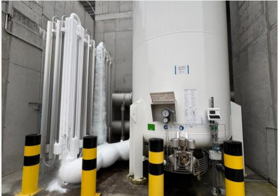
Serbatoio di ossigeno liquido
