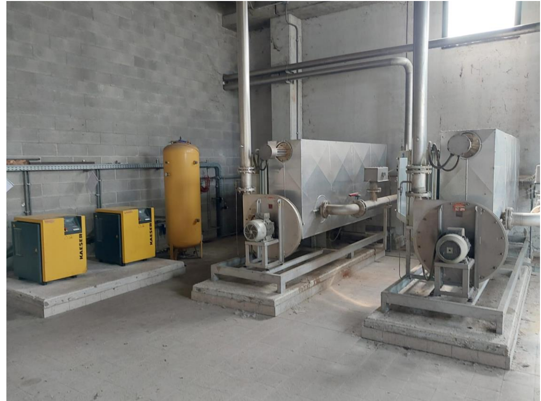
Distruttori di ozono residuo e compressori al servizio della sezione di ozonizzazione
